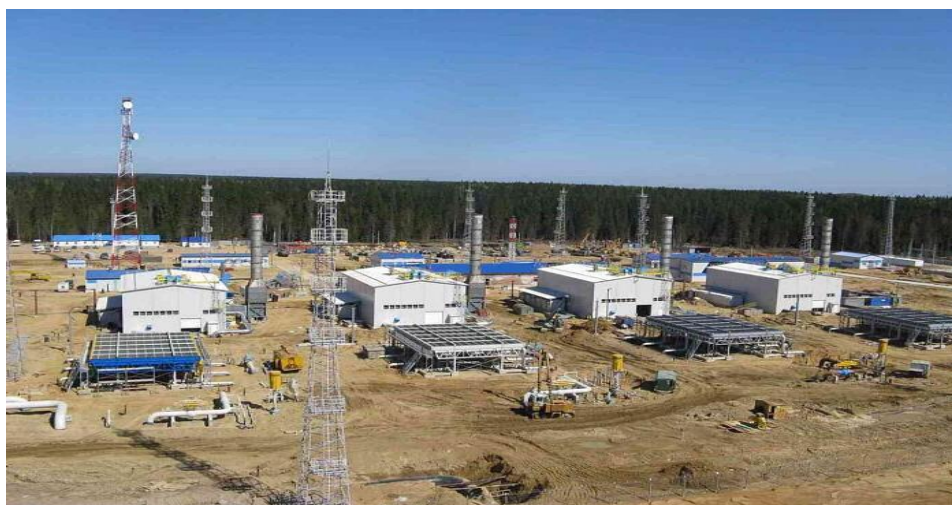
Мал.3. Компресорна станція магістрального газопроводу модульного виконання
